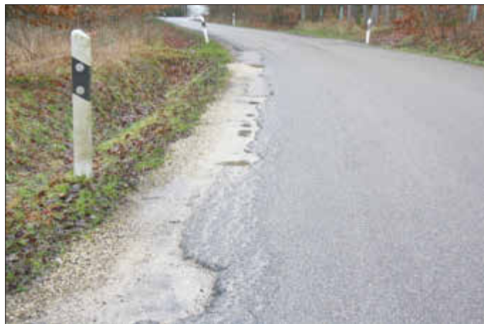
Am Fahrbahnrand zeigt der Straßenbelag deutliche Auflösungserscheinungen
