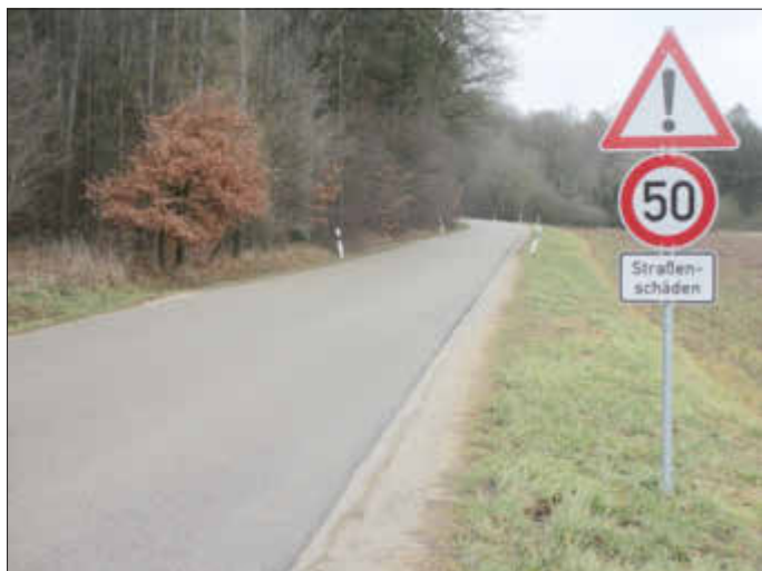
Straßenschäden sollen nach dem Ausbau der Vergangenheit angehören.
